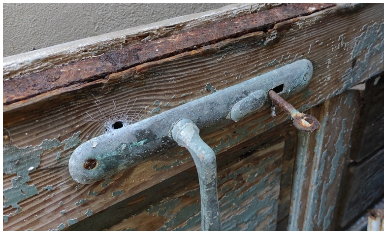
Металлический замок проржавел насквозь, но бронза и ключ в хорошем состоянии. 2023.
